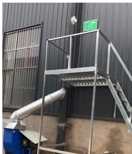
废气采样平台
