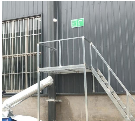
DA002 废气采样平台
